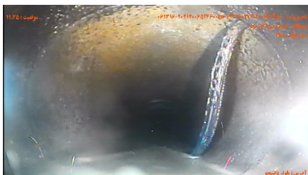
شماره تصویر ۳ عنوان آب بند معیوب/ورود و اثر آب بند به فضای داخل لوله-مهاجم موقییت ۱۱.۲۵ کد SR
