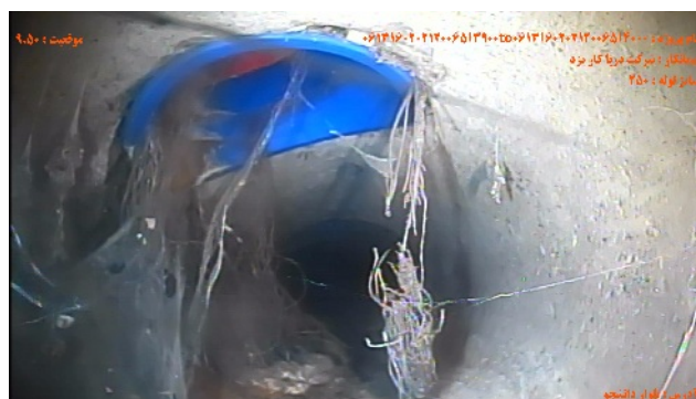
شماره تصویر ۴ عنوان نفوذ ریشه / نفوذ آبوه ریشه ها و کاهش سطح مقطع به میزان % ۱۰ موقعیت ۹۰۵۰ کد RM درصد ۱۰
