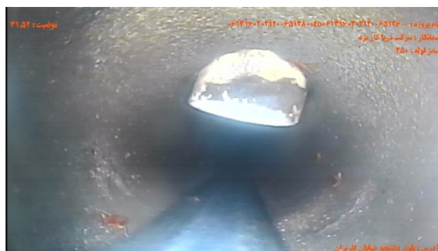
شماره تصویر ۴ عنوان موقیعت ۲۱.۵۲ کد CXI اتصال جانبی معيوب / انشعاب مهاجم - نفوذ به داخل لوله درصد ۱۰
