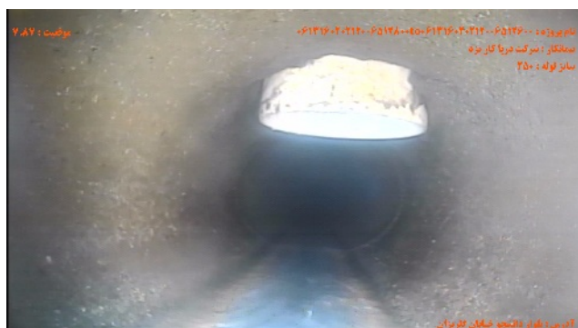
شماره تصویر ۳ عنوان موقیعت ۷.۸۷ کد CXI اتصال جانبی معيوب / انشعاب مهاجم - نفوذ به داخل لوله درصد ۱۰
