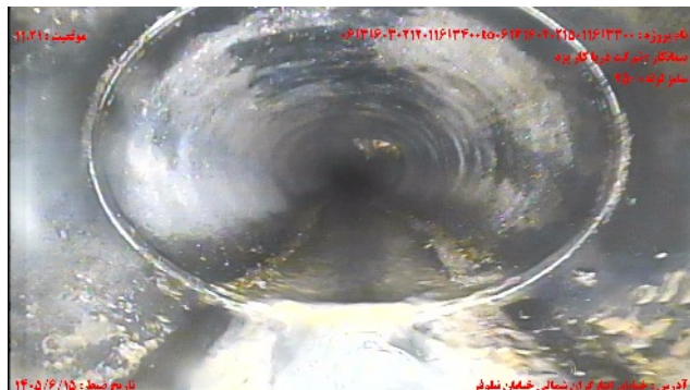
شماره تصویر ۷ موقعیت ۱۱.۲۱ کد SR عنوان آب بند معيوب/ورود و اشر آب بند به فضای داخل لوله —مهاجم
