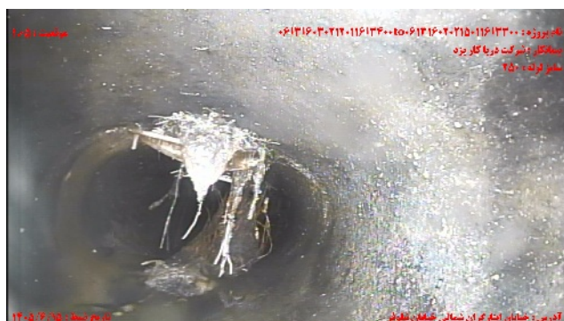
شماره تصویر ۳ عنوان موقعیت ۱۰۵ کد اتصال جانبی معيوب / اتصال معيوب انشعاب
