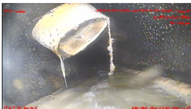
شماره تصویر ۳ عنوان اتصال جانبی معيوب /انشعاب مهاجم- نفوذ به داخل لوله موقعیت ۲۴.۳۰ کد CXI
