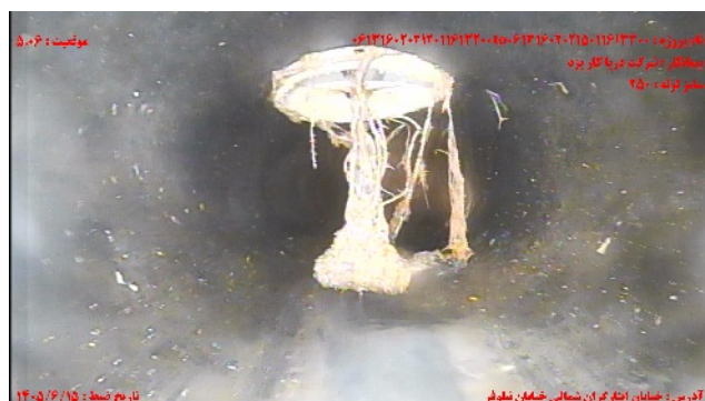
شماره تصویر ۴ عنوان موقیعت ۵۰۶ کد CX اتصال جانبی معيوب / اتصال معيوب اشعاب
