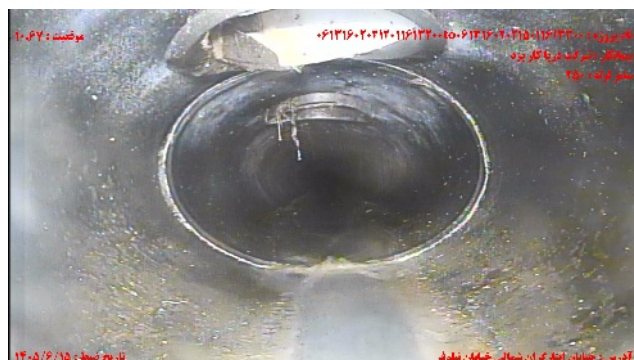
شماره تصویر ۶ عنوان موقیعت ۱۰۶۷ کد CX اتصال جانبی معيوب / اتصال معيوب اشعاب
