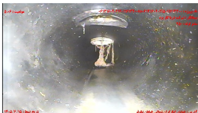
شماره تصویر ۳ عنوان موقیعت ۵۰۶ کد CX اتصال جانبی معيوب / اتصال معيوب اشعاب
