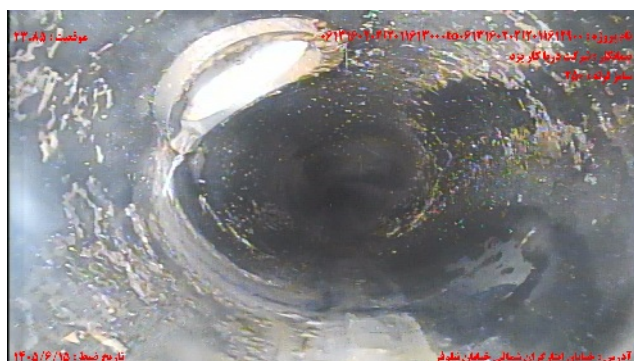
شماره تصویر ۹ موقیعت ۲۳.۸۵ کد CX عنوان اتصال جانبی معيوب / اتصال معيوب انشعاب
