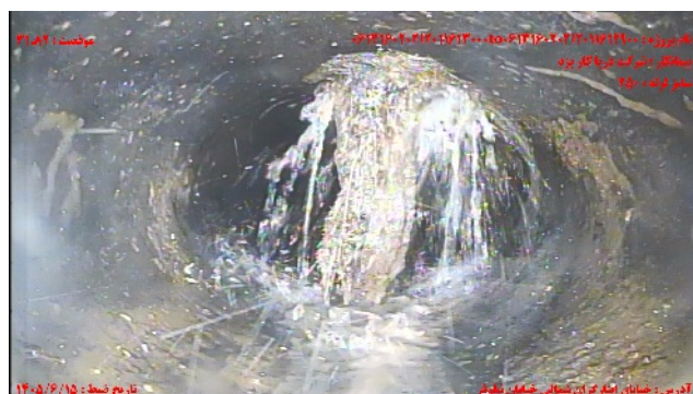
شماره تصویر ۱۰ موقیعت ۳۱.۸۲ کد CX عنوان اتصال جانبی معيوب / اتصال معيوب انشعاب
