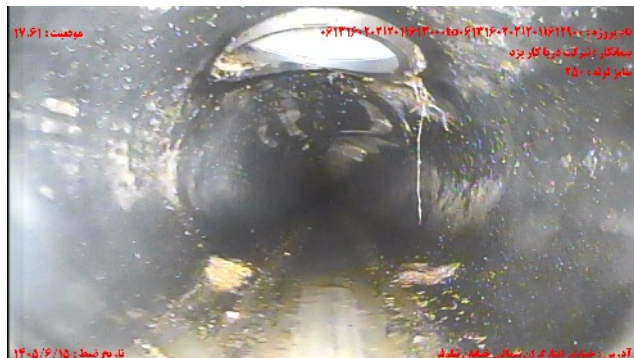
شماره تصویر ۷ موقیعت ۱۷.۶۱ کد CX عنوان اتصال جانبی معيوب / اتصال معيوب انشعاب
