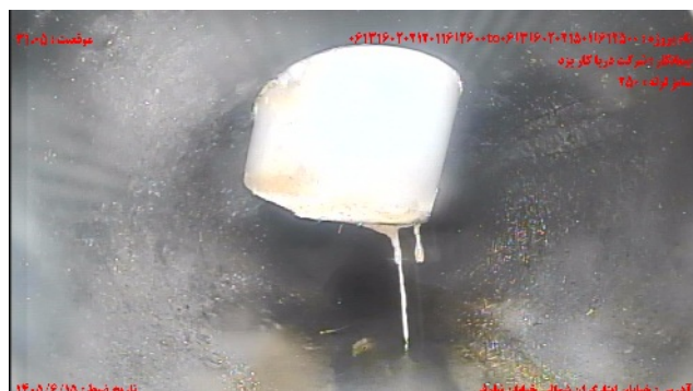
شماره تصویر ۶ عنوان موقعیت ۳۱۰۰۵ کد اتصال جانبی معيوب / انشعاب مهاجم - نفوذ به داخل لوله
