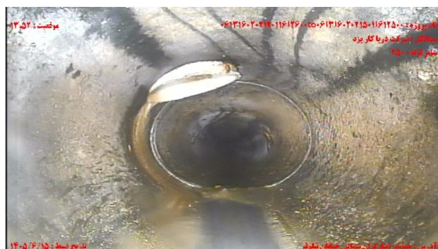
شماره تصویر ۴ عنوان موقعیت ۱۳۰۵۲ کد اتصال جانبی معيوب / اتصال معيوب انشعاب
