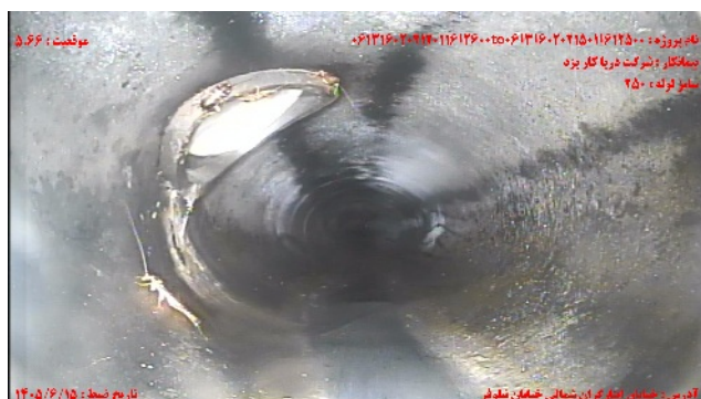
شماره تصویر ۳ عنوان موقعیت ۵۰۶۶ کد اتصال جانبی معيوب / اتصال معيوب انشعاب
