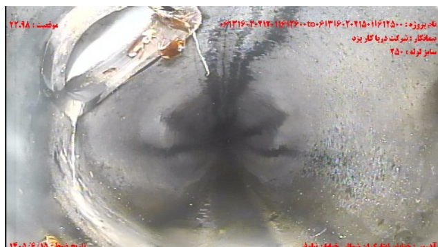
شماره تصویر ۵ عنوان موقعیت ۲۲۰۹۸ کد اتصال جانبی معيوب / اتصال معيوب انشعاب
