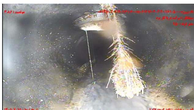
شماره تصویر ۳ عنوان موقعیت ۳۰۸۶ کد اتصال جانبی معيوب / اتصال معيوب انشعاب
