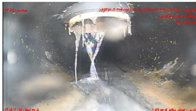
شماره تصویر ۸ عنوان اتصال جانبی معيوب/انشعاب مهاجم-نفوذ به داخل لوله موقعیت ۲۳.۲۵ کد CXI درصد ۱۵
