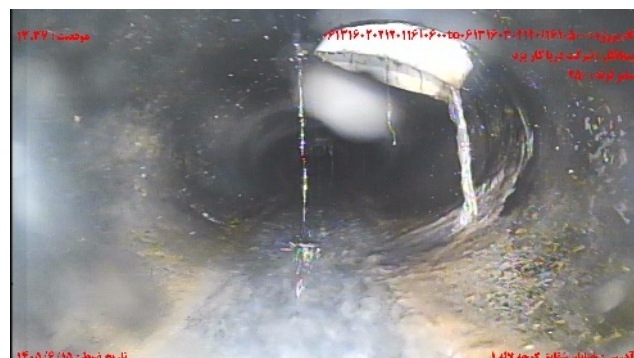
شماره تصویر ۶ عنوان موقعیت ۱۳۰۳۷ کد اتصال جانبی معيوب / اتصال معيوب انشعاب
