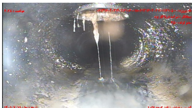
شماره تصویر ۵ عنوان موقعیت ۷۰۷۸ کد اتصال جانبی معيوب / اتصال معيوب انشعاب
